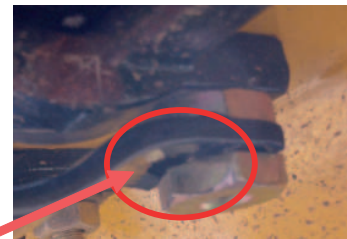
Falscher Anbau: Die Gabel ist nicht bis zum Anschlag in die Spulenrolle geschoben.
